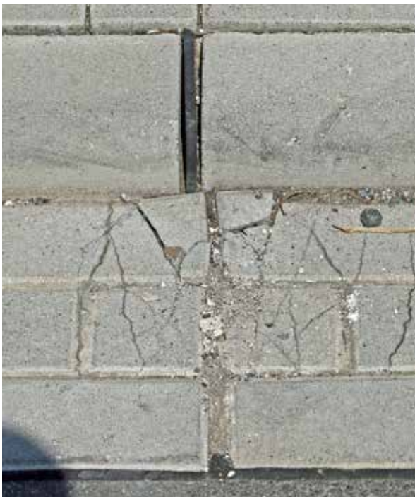
Abb. 5: Ausbrüche an den Pflastersteinen in direkter Nachbarschaft zu einer Bewegungsfuge
