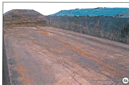
Undichtigkeit im Bereich der Bauteilanschlüsse
