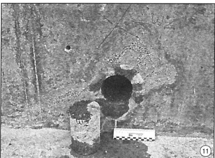
Gefügestörungen in den Wandoberflächen einer Biogasanlage
