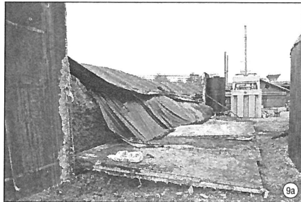
Schäden aufgrund der Korrosion der Anschlussbewehrung
