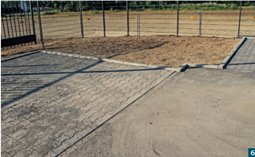
6 und 7 Einwirkung von Baustellenschmutz
