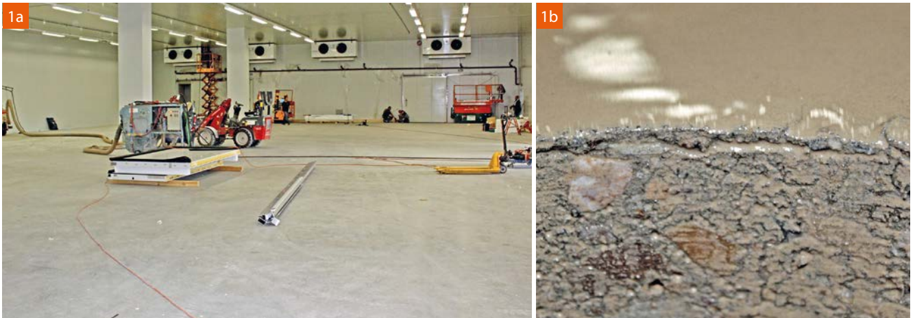
Abb. 1a und 1b: Hohlstellen in einem Industrieboden.
