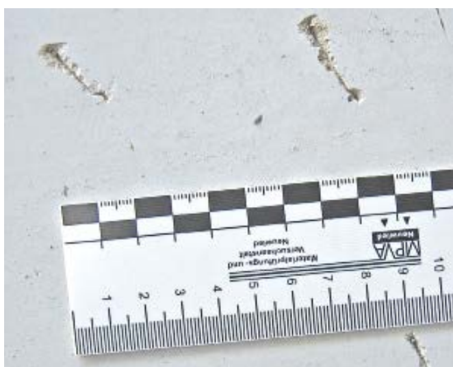
Abb. 1 In der Plattenoberfläche sichtbare Stahlfasern.
