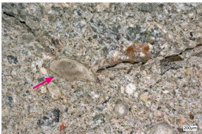
Abb. 1 a-c: Abriss im Beton unterhalb einer Kunstharzbeschichtung
