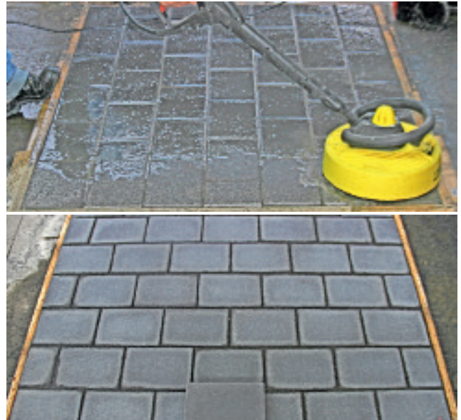
Abbildung 6: Oben: Reinigung mit einem Niederdruck-Flächenreiniger, unten: Verfärbung nach der Reinigung..
