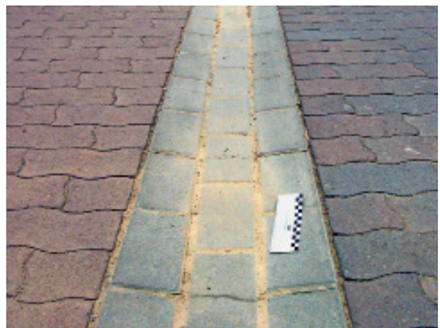
Abbildung 6: Rinnenanlage mit in regelmäßigen Abständen auftretenden Rissen.
