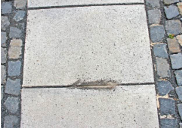
Abbildung 2: Fugenmörtel mit geringer Festigkeit.
