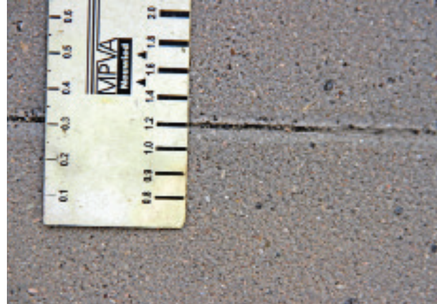
Abbildung 4: Fugen mit sehr geringer Fugenbreite.
