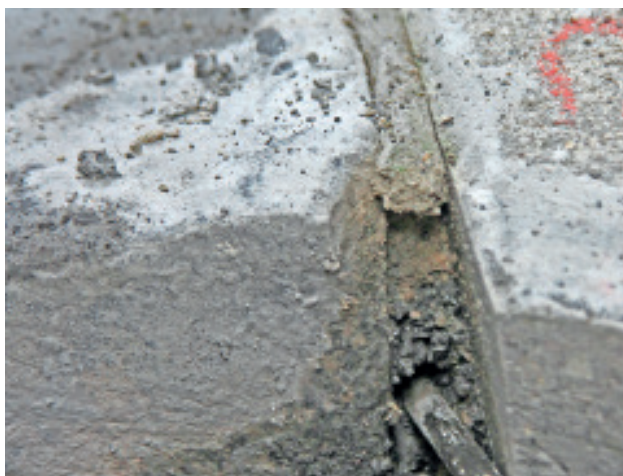
Abbildung 5: Fugenfüllung zwischen den Betonplatten.
