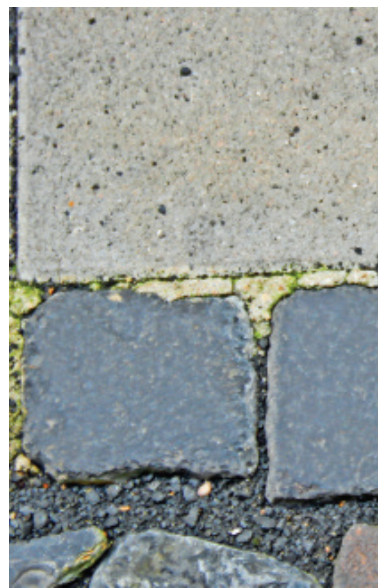
Abbildung 3: Risse im und Ausbrüche am Fugenmörtel.
