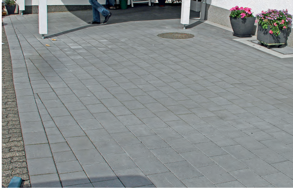
5. Verfärbungen aufgrund der Verkrallung der Feinanteile des Fugenmaterials in der Steinoberfläche.
