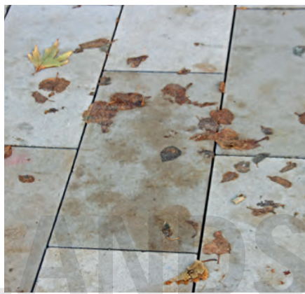
6. Verfärbungen durch die Verschmutzung von Pflasterdecken durch Grünbeläge (li.) oder Baustellenschmutz (re.).
