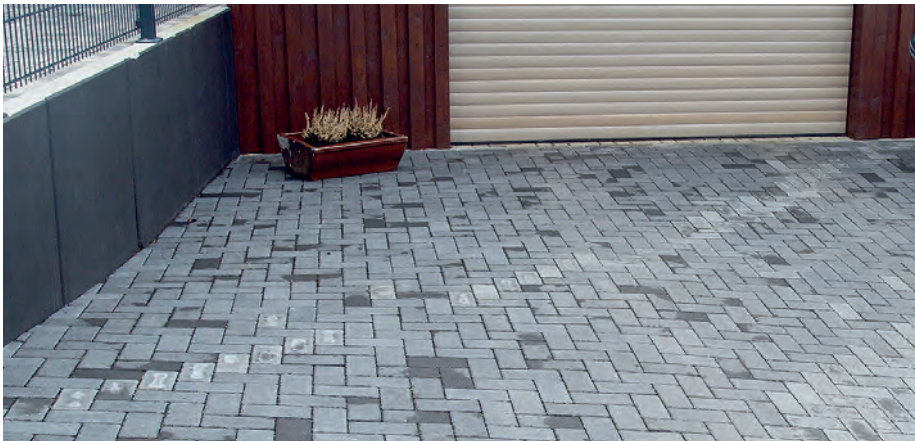
3. Verfärbungen an einer Pflasterdecke aufgrund vorliegender Ausblühungen.
