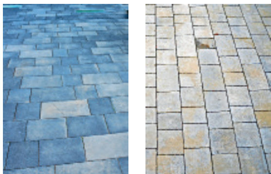
Abbildung 3: Verfärbung von Pflastersteinen aus Beton infolge der Verschmutzung durch anstehenden Boden.
