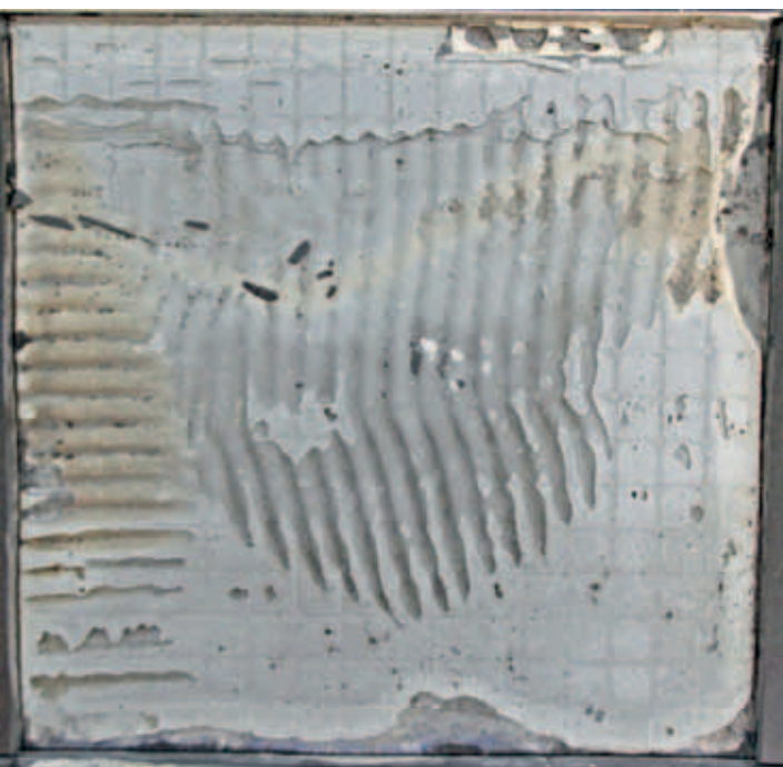
2 Hohlstellen unter den Fliesen durch Fliesenkleber in unterschiedlicher Dicke
