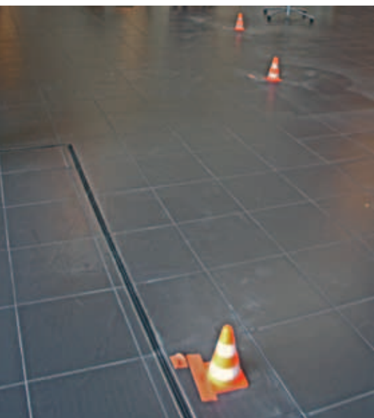
3 Nicht sachgerecht auf der Bodenplatte verankertes Fugenprofil
