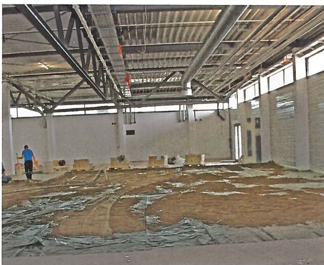
Bild 3: „Verdursten“ des vorgelegten Bettungsmörtels.
