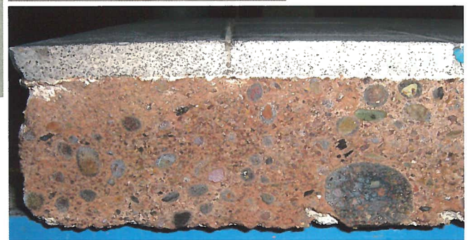
Bild 13 unten: Zementlinsen bei Verwendung werkgemischter Mörtel.
