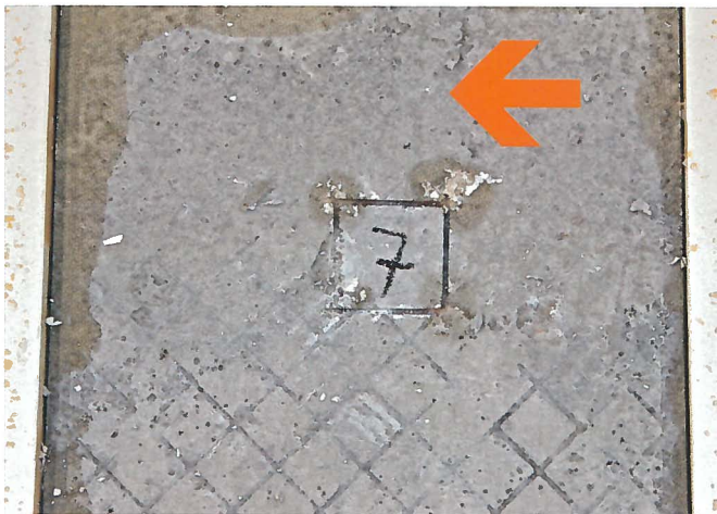
Bild 14: Teilfläche ohne Eindruckstellen der Profilierung der Unterseite der keramischen Platten in der Kontaktschlämme.
