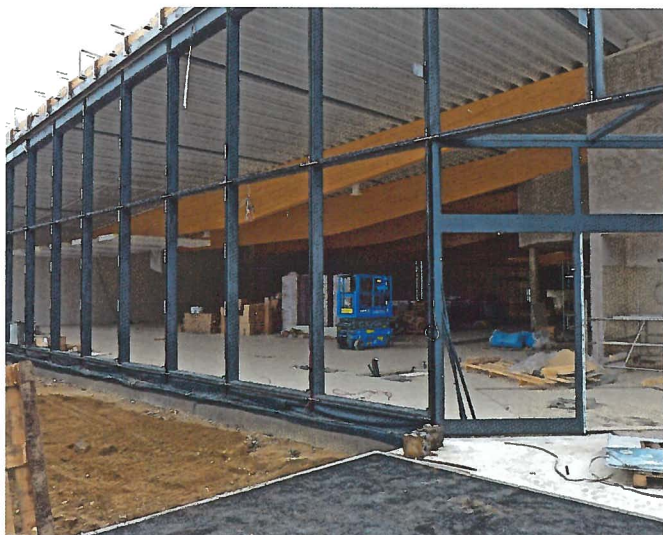
Bild 2: Fehlendes Abhängen von Türen und Fenstern im Bauzustand.
