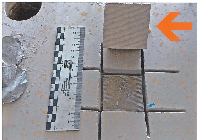
Bild 15: Keramische Platten ohne Anhaftung der Kontaktschlämme.
