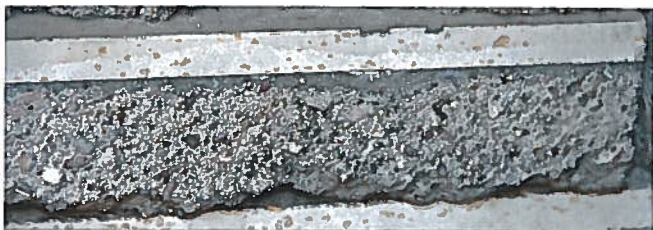
Abb. 2: Guter Verbund des »Rüttelbodens« bei ausreichend dicker Haftschlämme
