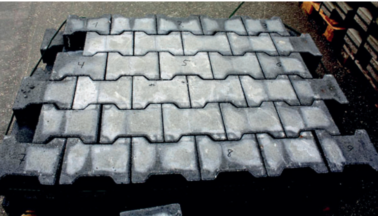
Abb. 6: Aussinterungen von Kalkhydrat aus dem Kernbeton der darüber liegenden Pflastersteine
