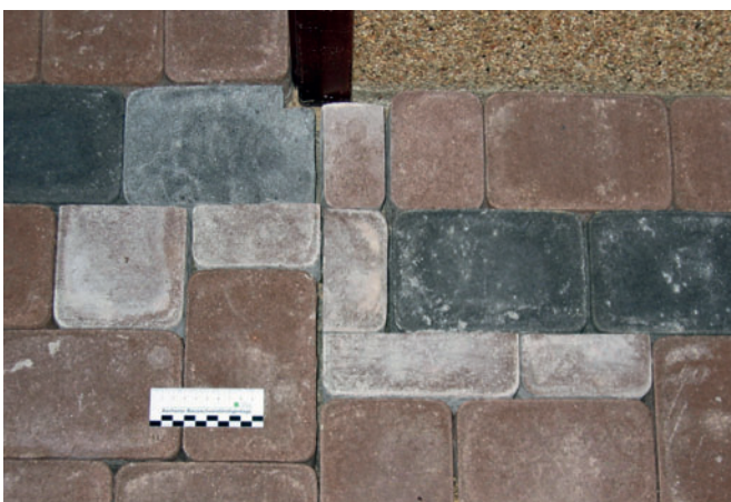
Abb. 2: Über das übliche Maß hinausgehende (baustoffuntypische) Ausblühungen
