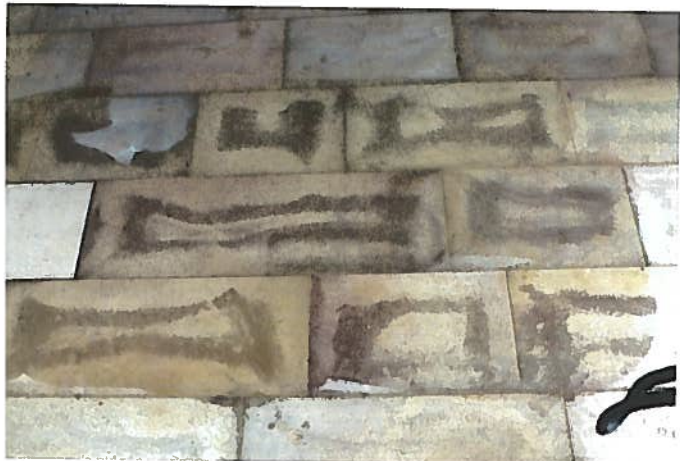
Abb. 3: Nicht für den Verwendungszweck geeignete Imprägnierung auf einem Sandsteinbelag (Foto: Henning Rohowski)
