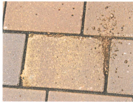
Abb. 14: Massiv zermürbte Pflastersteinkanten
