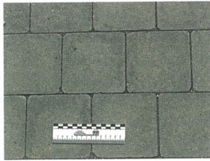
Abb. 10 a+b: Kantenschäden durch Verwendung einer Rüttelplatte ohne Plattengleitvorrichtung
