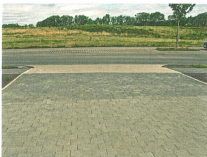
Abb. 6 a+b: Verfärbung von Steinoberflächen durch den Eintrag von Fugenmaterial Oben: Flächenbefestigung mit Verfärbungen durch das Fugenmaterial Rechts: Einschlämmversuch eines kritischen Fugenmaterials auf einen sauberen Pflasterstein
