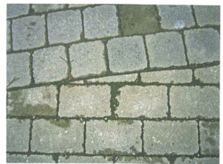
Abb. 7: fehlerhafter Zuschnitt von Passsteinen
