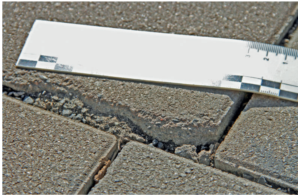
Abb. 8: Kantenschäden an einem Höhenversatz zwischen benachbarten Pflastersteinen
