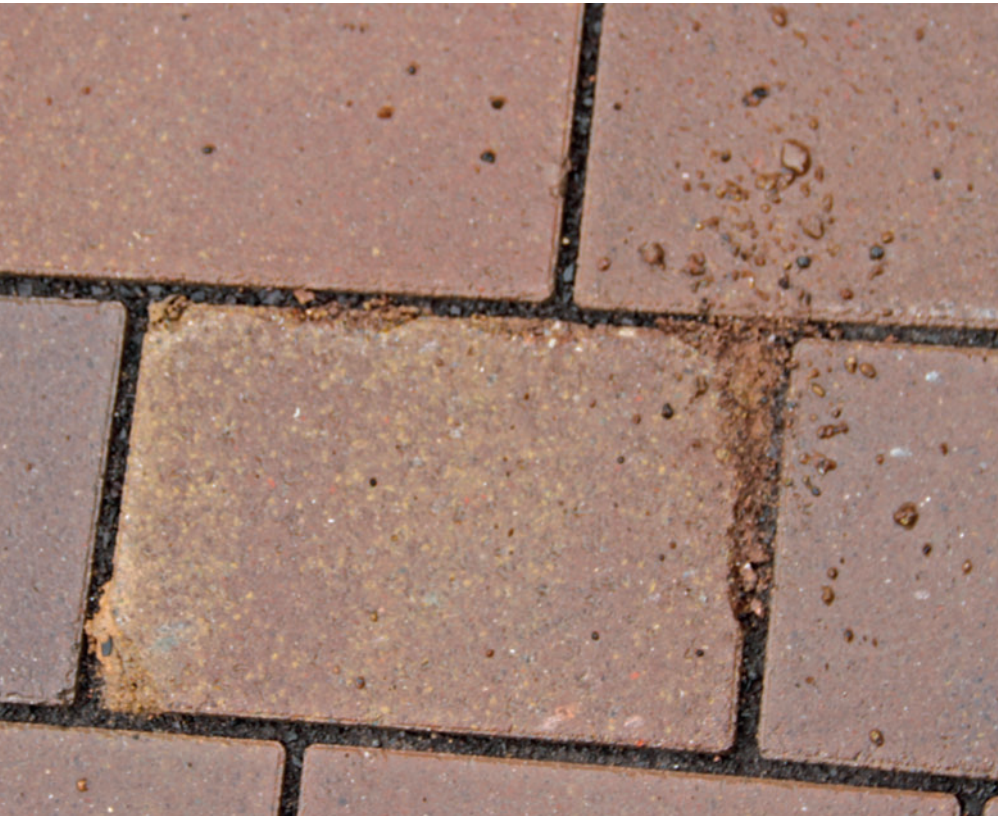
Abb. 14: Massiv zermürbte Pflastersteinkanten
