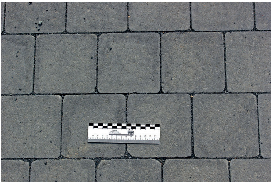
Abb. 10: Kantenschäden durch Verwendung einer Rüttelplatte ohne Plattengleitvorrichtung
