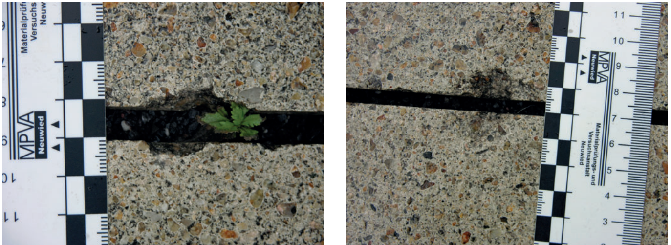
Abb. 9: Schäden an den Kanten benachbarter Pflastersteine
