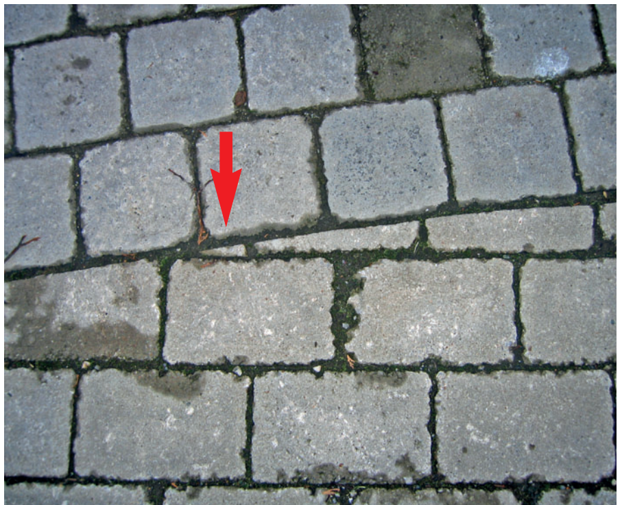
Abb. 7: Fehlerhafter Zuschnitt von Passsteinen
