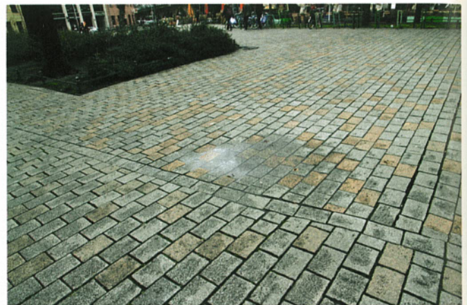
Bild 1: Schäden aufgrund einer nicht ausreichenden Wasserdurchlässigkeit der Konstruktion
