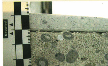
1a und 1b Trennlage zwischen dem Bettungsmörtel und dem starren keramischen Belag aufgrund einer fehlenden Kontaktschicht
