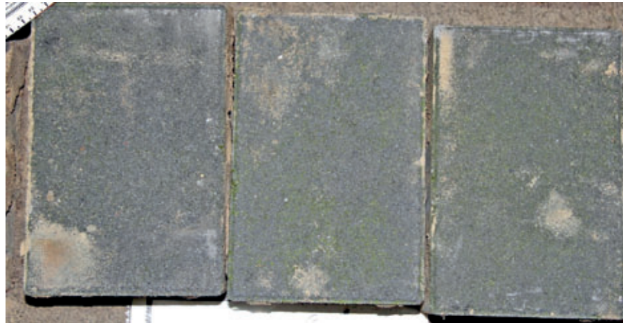
Bild 18: Betonpflastersteine mit aufsitzenden Verschmutzungen
