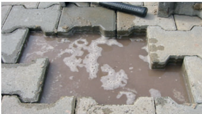
Bild 16: Nicht ausreichend wasserdurchlässige Konstruktion
