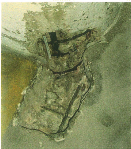
Bild 14: Bereiche mit chloridinduzierter Stahlkorrosion
