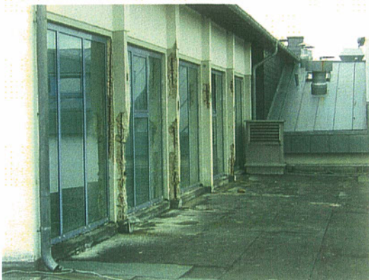
Bild 12: Betonabplatzungen durch Korrosion des Bewehrungsstahls
