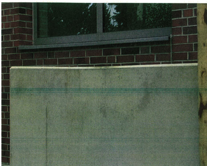
Schiefer Wandkopf infolge verzogener Schalung
