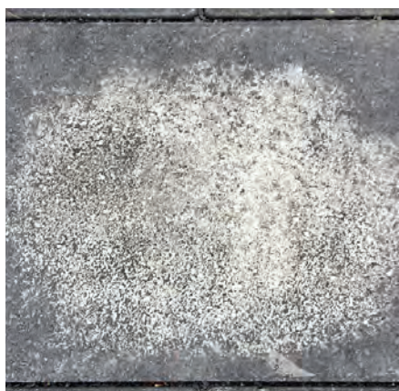
2. Beeinflussung des optischen Erscheinungsbildes einer Pflasterdecke durch massive Ausblühungen.
