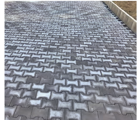
9. Betonpflastersteine mit massiven Sekundärausblühungen.
