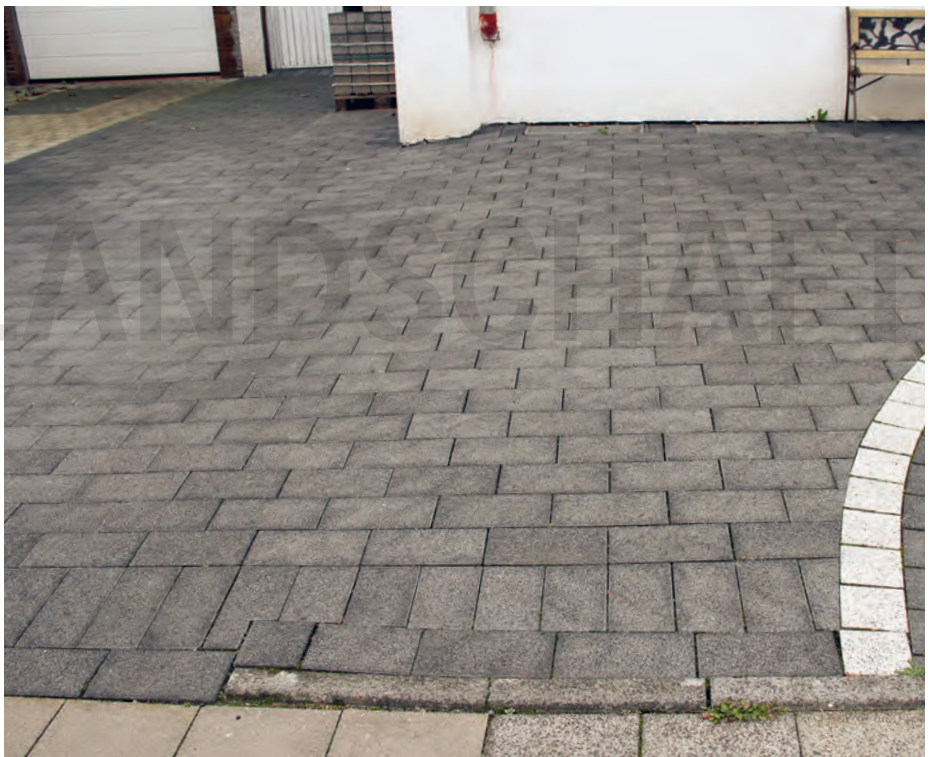
5. Typisches Erscheinungsbild von Tertiärausblühungen auf Betonplatten.
