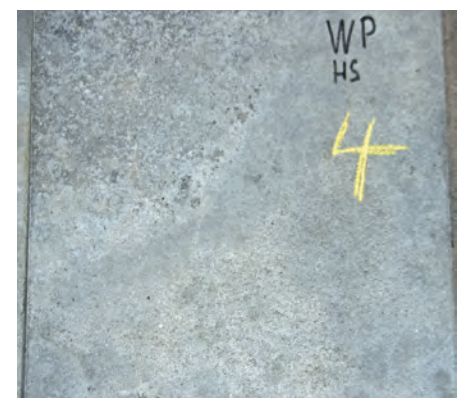
8. Betonplatte mit einer erhöhten Ausblühneigung.
