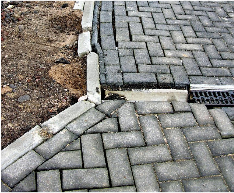
Schlechte Betonqualität und schlechter Verbund zwischen Rückenstützbeton und Bordsteinanlage führte zu Verschiebungen.
