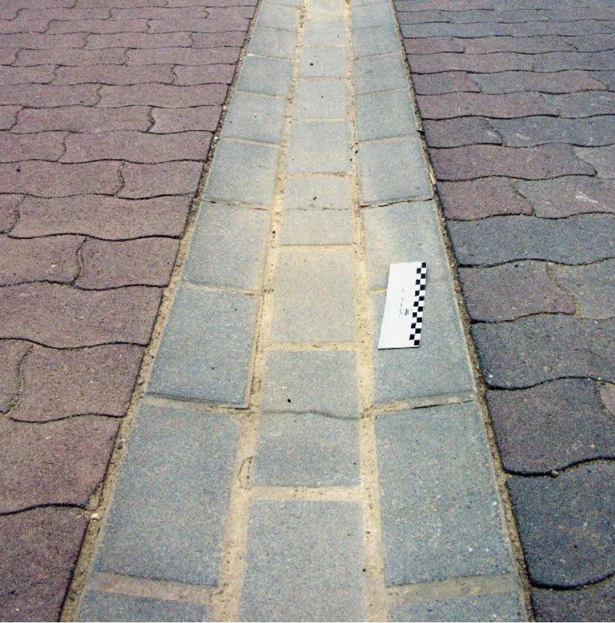
Bei zu trockenem Fundamentbeton blieben Risse in der Rinnenanlage nicht aus.
