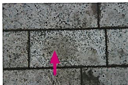
Abb. 12: Verfärbungen durch die Verwendung eines schwarzen Fugenmaterials bei weiß eingefärbten Betonpflastersteinen
