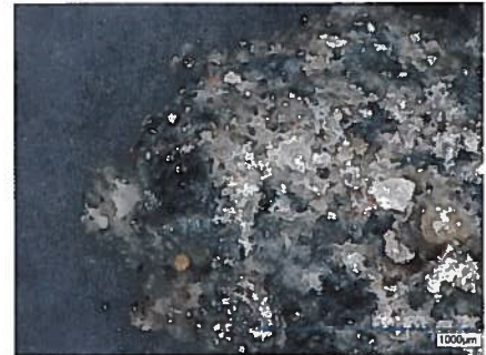
Abb. 7 a+b: Digitalmikroskopische Untersuchung eines verfärbten Pflastersteins und der aus der Steinoberfläche abgetrennten Verschmutzung; oben: verschmutzte Steinoberfläche / unten: gewonnene Verunreinigung
