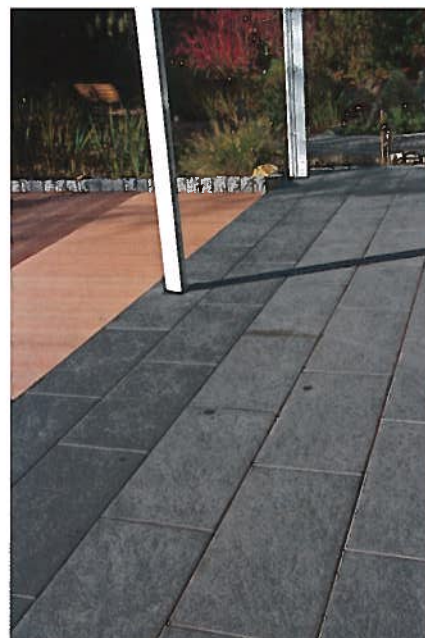
Abb. 11 a+b: Terrassenfläche mit verfärbten anthrazitfarbenen Betonplatten
