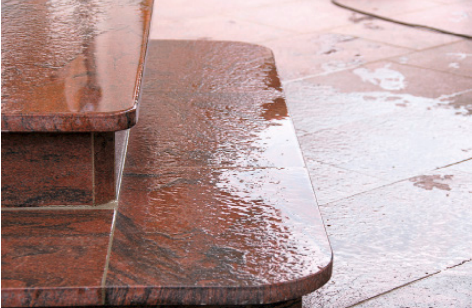
Bild 89 Pfützenbildung bei unzureichender Entwässerungsneigung [Quelle: Burgetsmeier]
