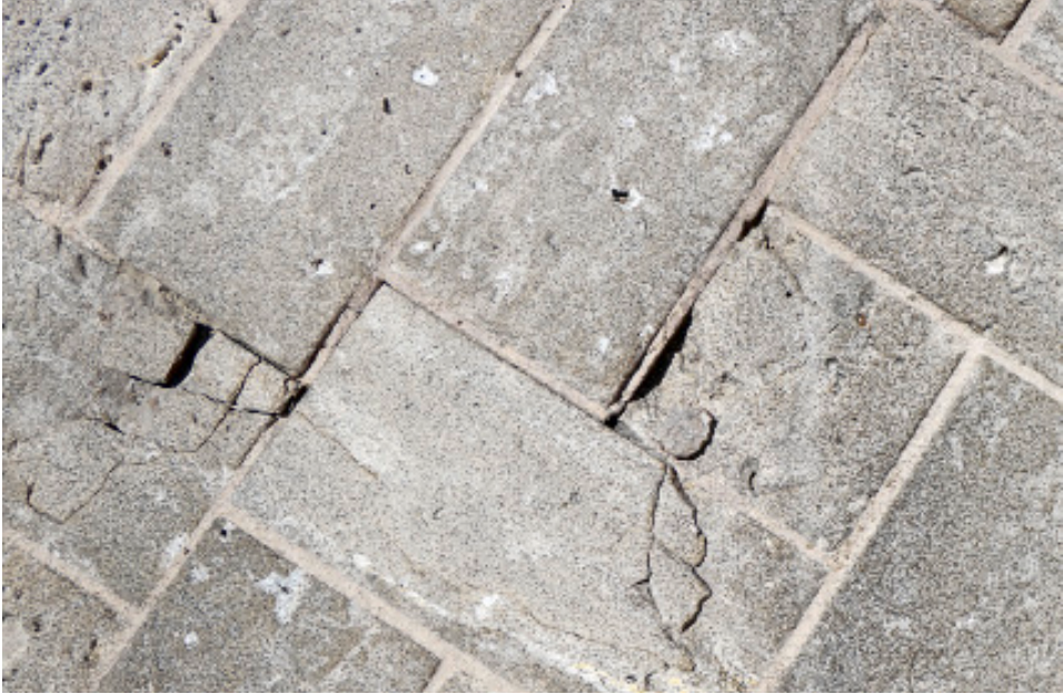
Bild 107 Sichtbare Gesteinsablösungen als Folge technischer Mängel [Quelle: Burgetsmeier]
