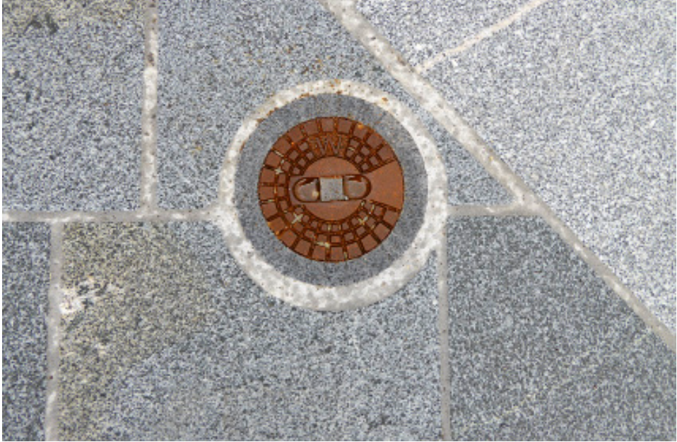
Bild 124 Schmale Zuschnitte wegen Einbauteilen erhöhen die Gefahr von Eck-/Kantenabplatzungen sowie Rissen [Quelle: Burgetsmeier]
