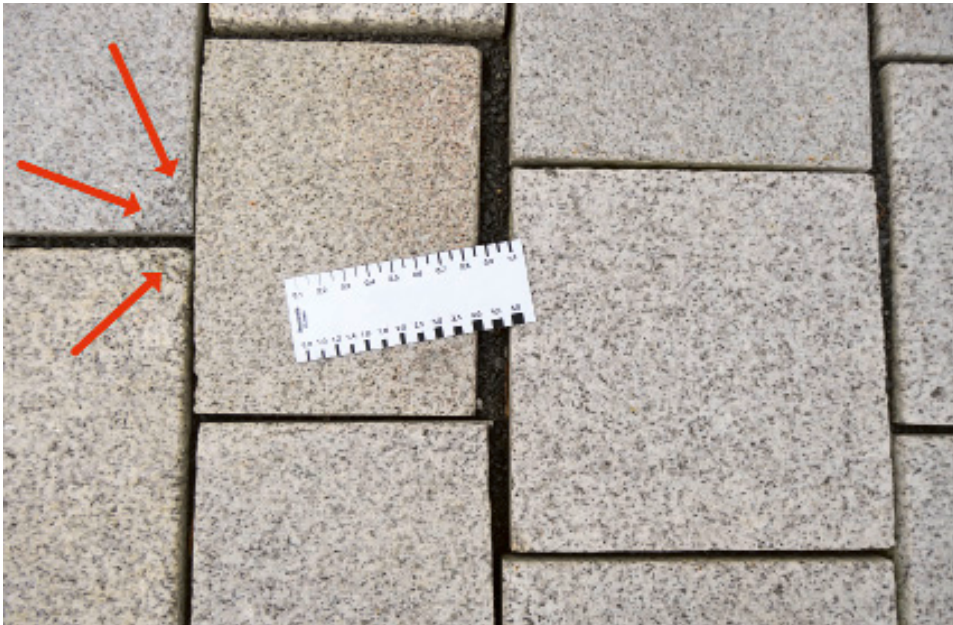
Bild 130 Aufgrund des Fehlens von Fugenmaterial kommt es zu Verschiebungen der Belagselemente und bereits im Bauzustand zu Eck-/Kantenabplatzungen [Quelle: Burgetsmeier]
