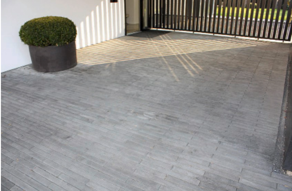
Bild 92 Feuchteverflektungen und Ausblühungen infolge Carporteffekt [Quelle: Rohowski]
