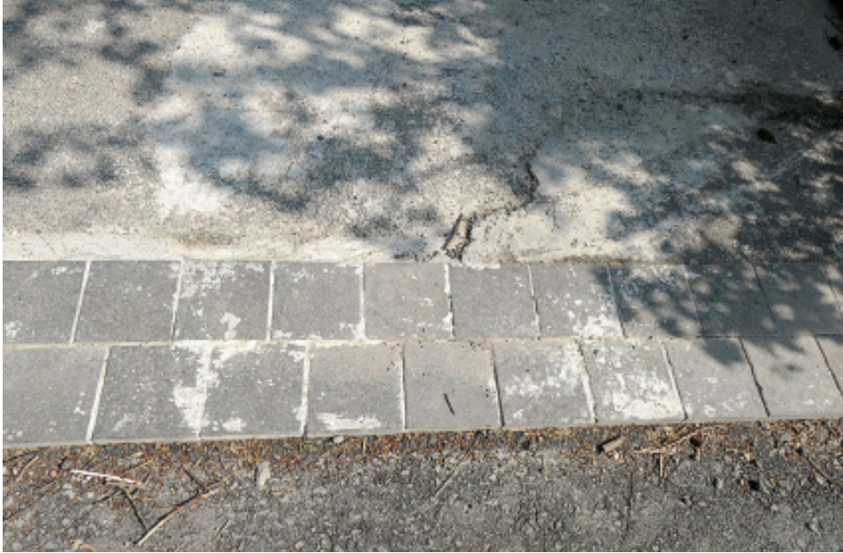
Bild 98 Verschmutzung der Werksteinoberflächen durch Rückstände der Fugenfüllung [Quelle: Burgetzmeier]
