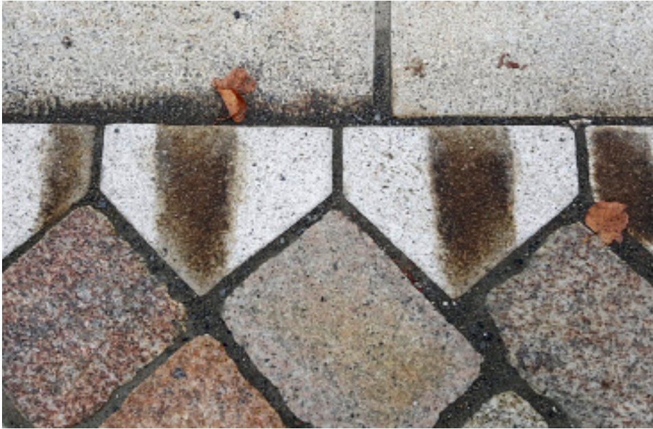
Bild 78 Verfärbungen durch den Abrieb der Gabelzinken eines Gabelstaplers [Quelle: Reckling]
