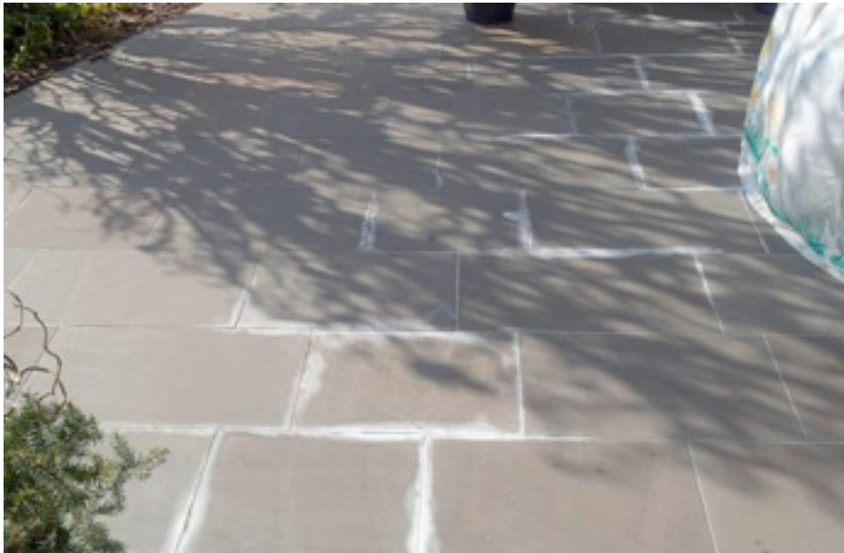
Bild 10 Salzablagerungen (Ausblühungen) im Fugenbereich unter Überdachung [Quelle: Rainer Krug, DNV]
