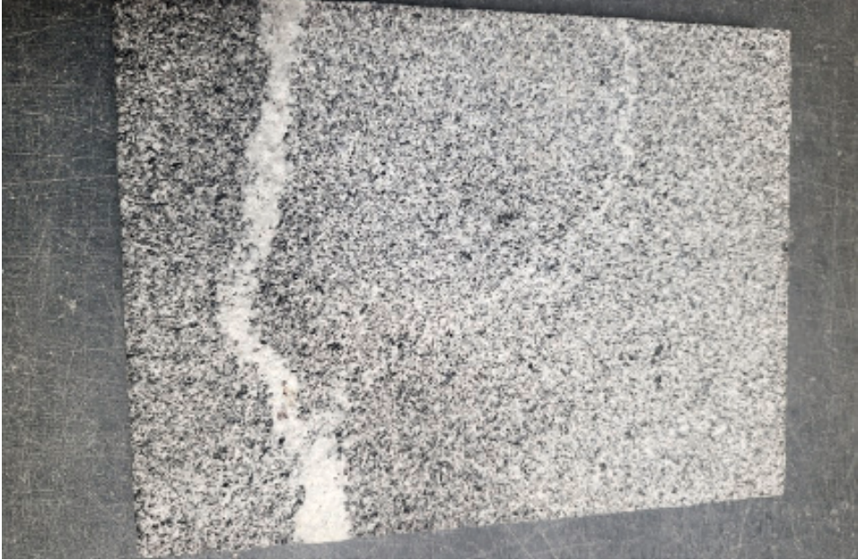
Bild 83 Farbveränderung am linken Bildrand durch nicht fachgerecht angewandten Rostentferner [Quelle: Reckling]
