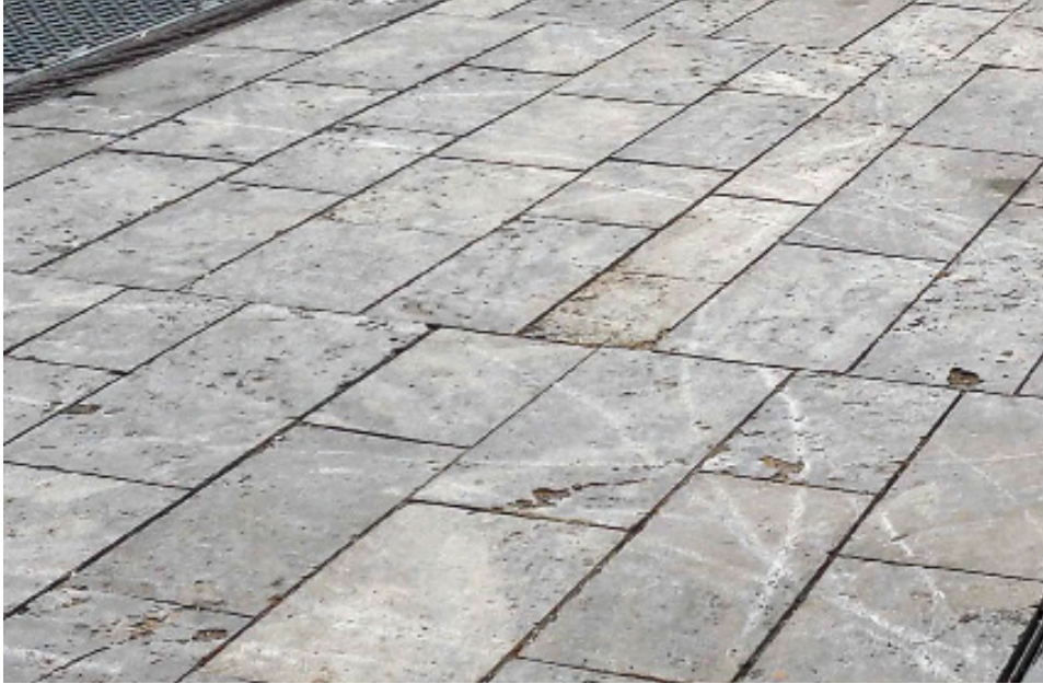
Bild 44 Bodenbelag aus Muschelkalk mit entstehungsbedingten Poren und Fehlstellen [Quelle: Rohowski]
