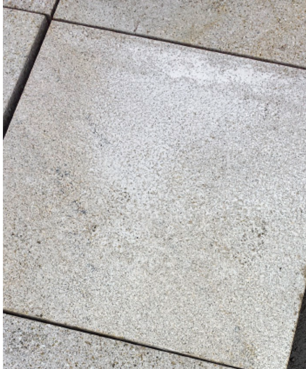
Bild 104 Ausführungsbedingte Verschmutzungen (Sägeschlamm vom Zuschnitt) [Quelle: Reckling]
