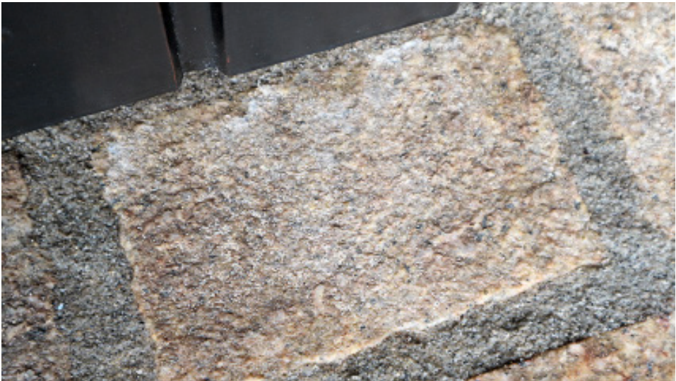
Bild 93 Ausblühungen auf Natursteinoberfläche [Quelle: Denis Vahle]
