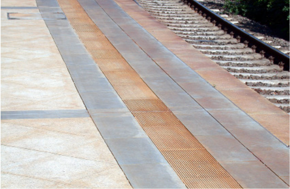
Bild 118 Flugrost durch Zugverkehr neben Gleisanlage [Quelle: La Bouchardiere]
