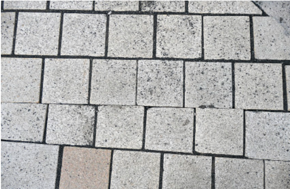
Bild 131 Eck-/Kantenabplatzungen aufgrund von Pressfugen an gesägten Naturwerksteinkanten [Quelle: Burgetsmeier]
