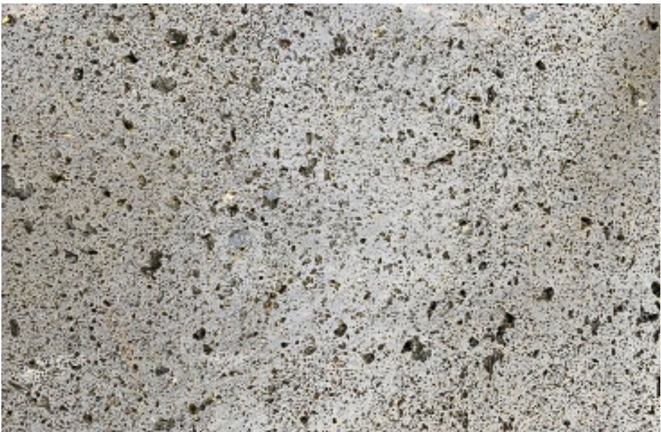
Bild 39 Basaltlava mit entstehungsbedingten Poren [Quelle: Köhnken]
