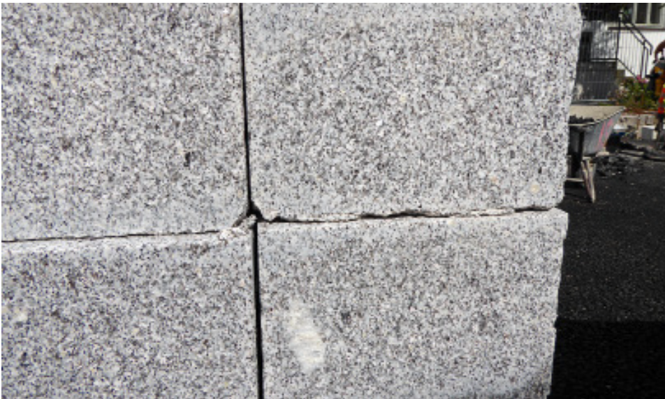
Bild 143 Durch das Flammen bis zur Werksteinkante werden häufig Eck-/Kantenabplatzungen verursacht [Quelle: Burgetsmeier]
