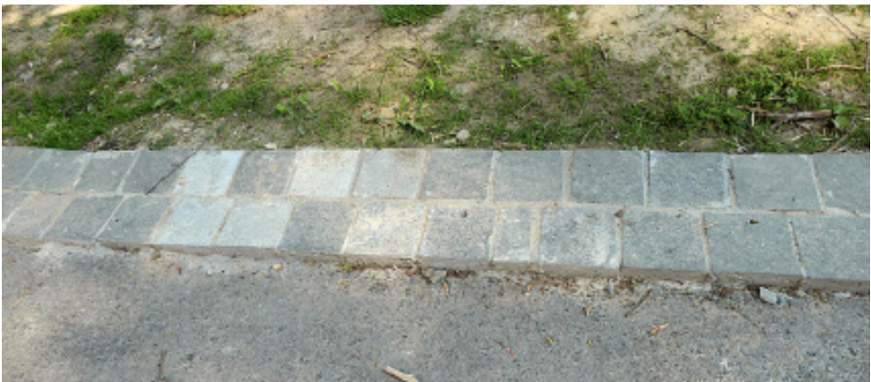
Bild 97 Verschmutzung der Werksteinoberflächen durch Rückstände der Fugenfüllung [Quelle: Burgetzmeier]
