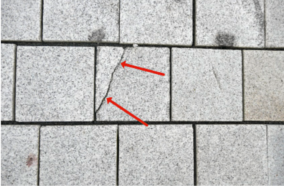
Bild 151 Durchgehender Riss/gebrochener Naturwerkstein [Quelle: Burgetsmeier]
