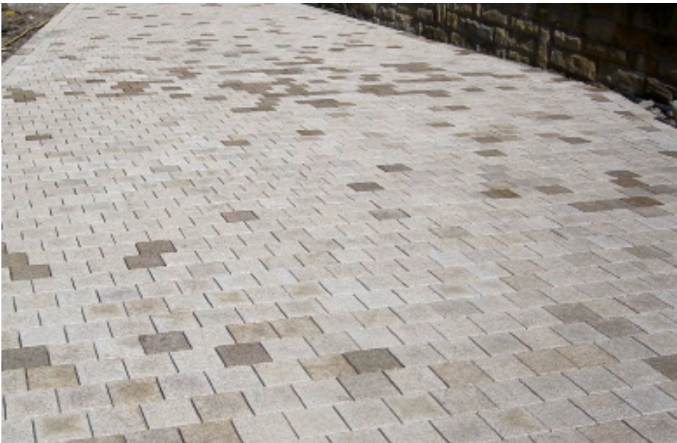
Bild 11 Unterschiedliches Abtrocknungsverhalten [Quelle: Reckling]
