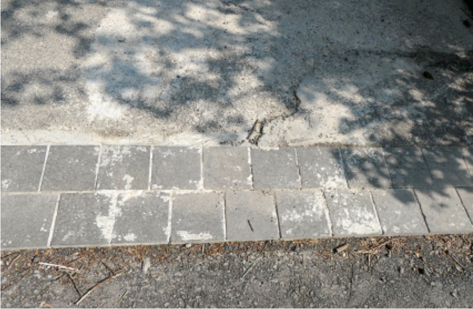
Bild 105 Unsachgemäße oder fehlende Baustellenendreinigung [Quelle: Burgetsmeier]
