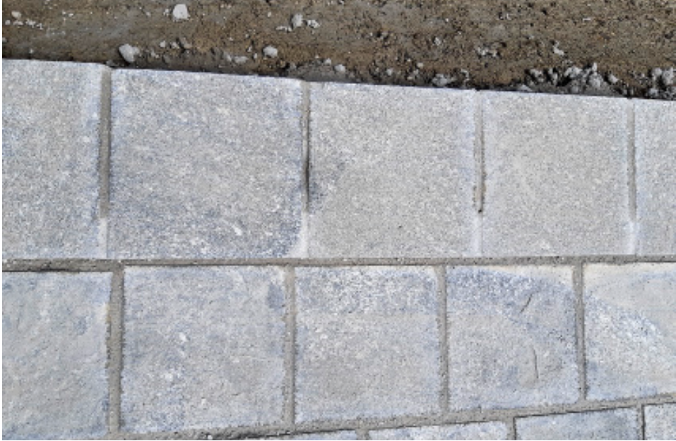
Bild 100 Verschmutzung der Werksteinoberflächen durch Rückstände der Fugenfüllung [Quelle: Schaller]
