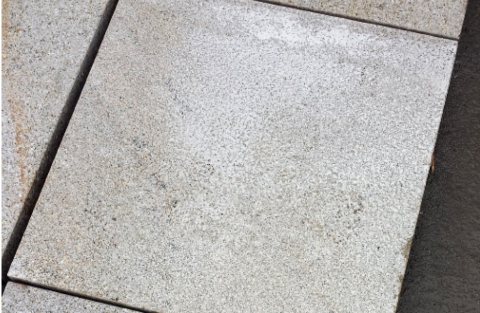
Bild 76 Oberseite durch Schneidschlamm verschmutzt [Quelle: Reckling]
