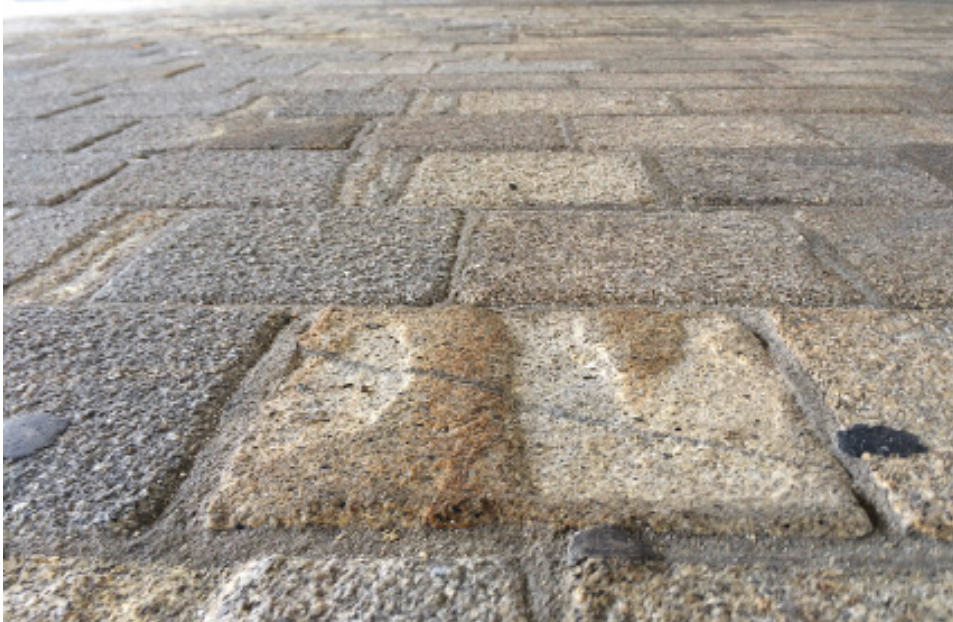
Bild 119 Schäden durch langanhaltende Einwirkung von Tausalz ohne Abwitterung/Bewässerung (z. B. überdacht) [Quelle: Burgetsmeier]
