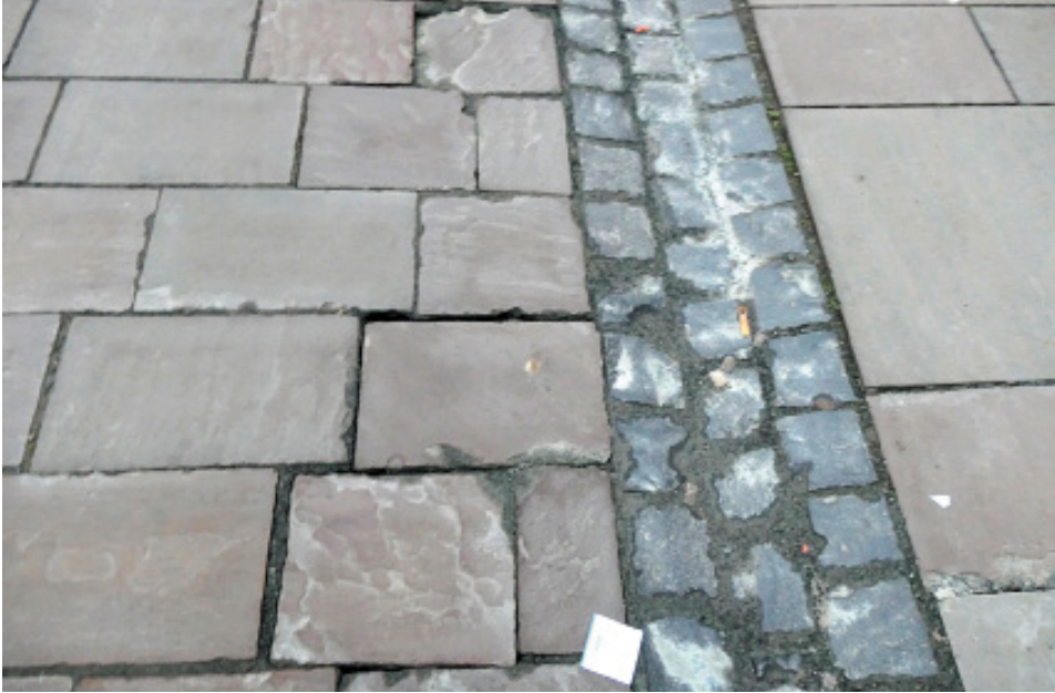
Bild 142 Schlechte Wartung oder zu geringe Dimensionierung [Quelle: Burgetsmeier]
