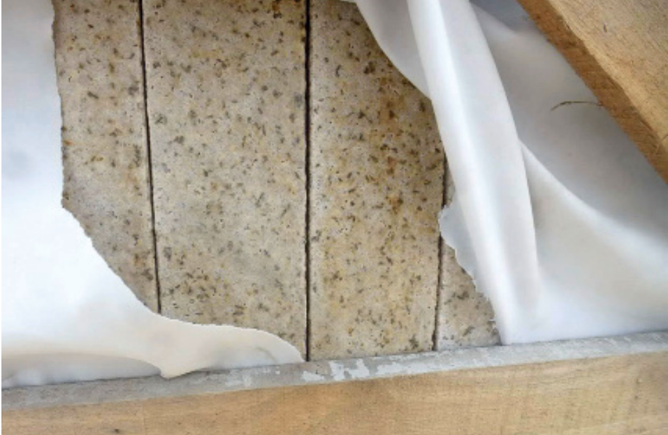
Bild 55 Flächige Rostverfärbung im Naturwerkstein [Quelle: Reckling]
