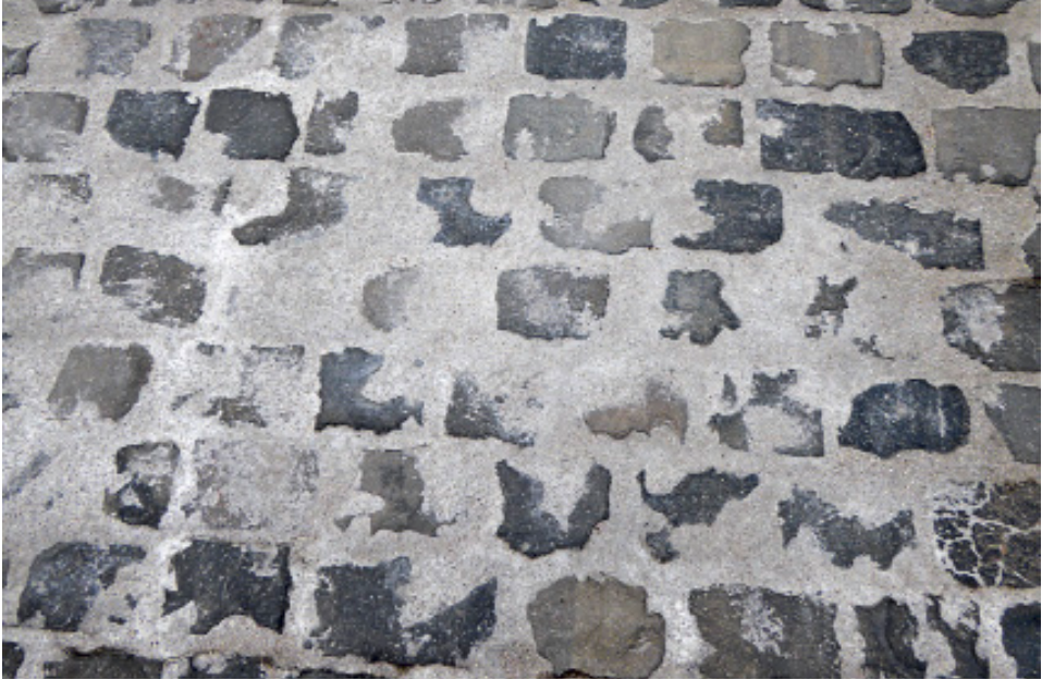
Bild 99 Verschmutzung der Werksteinoberflächen durch Rückstände der Fugenfüllung [Quelle: Burgetzmeier]
