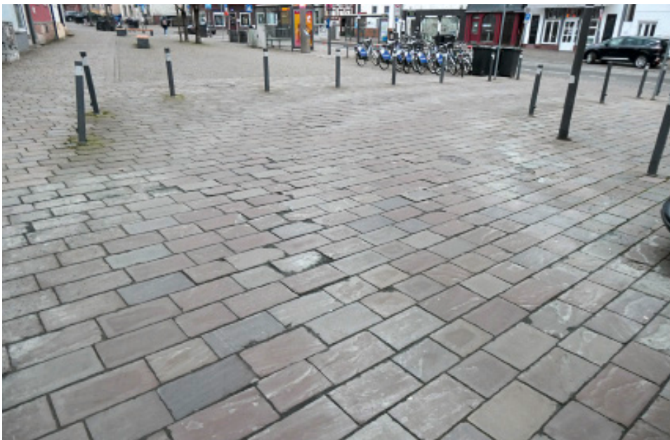
Bild 141 Schlechte Wartung oder zu geringe Dimensionierung [Quelle: Burgetsmeier]
