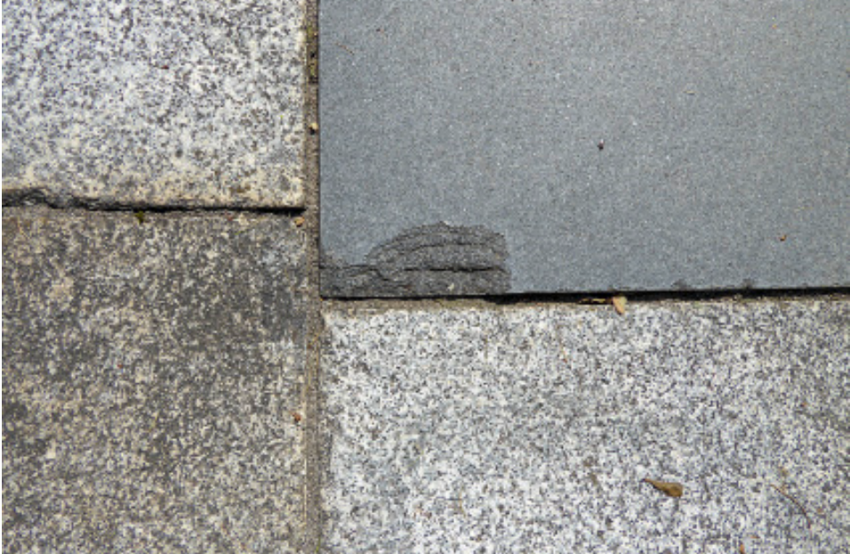
Bild 146 Muschelförmige Abplatzung mit mehreren Zentimetern Breite [Quelle: Burgetsmeier]
