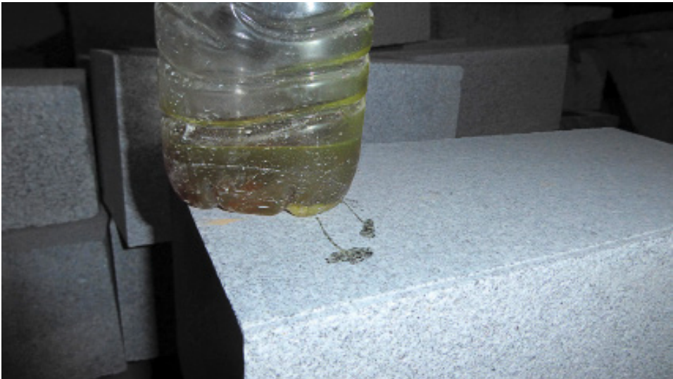
Bild 77 Fleckenbildung durch Öleintrag im Bereich der Oberfläche [Quelle: Burgetsmeier]
