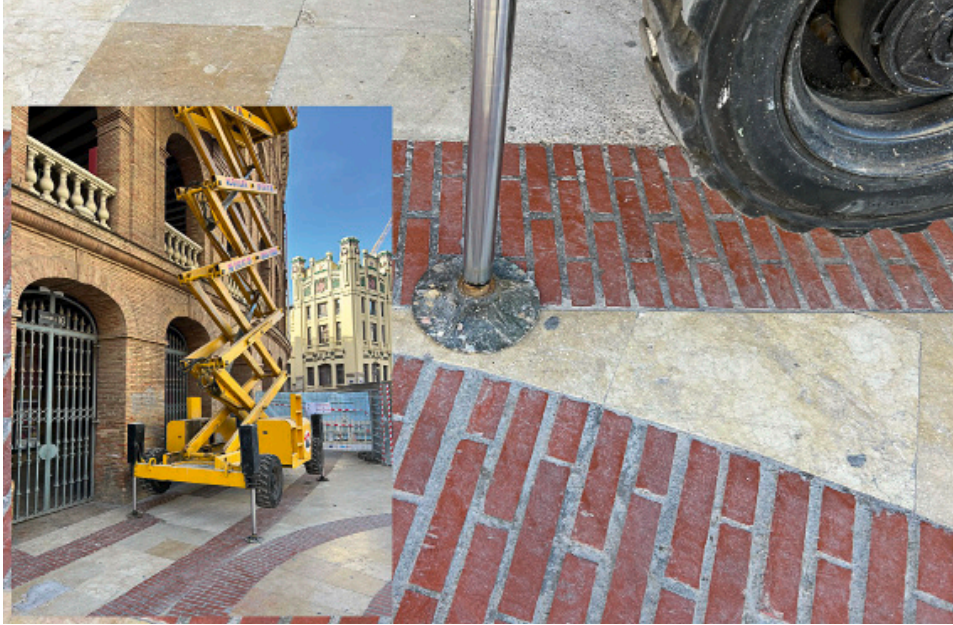
Bild 153 Hydraulische Stützenfüße ohne Lastverteilungsplatte führen zu punktförmigen Lasten und können Eck-/Kantenabplatzungen verursachen [Quelle: Burgetsmeier]
