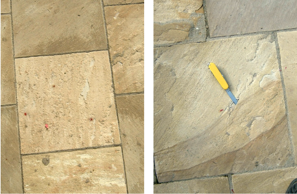
Bild 21 Sandsteine mit Abplatzungen/Aufschieferungen [Quelle: Henn]
