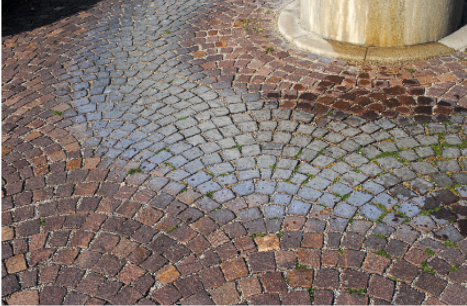
Bild 121 Lösliche Bestandteile, die sich aus Grund-, Leitungs- und/oder Brunnenwasser auf der Oberfläche ablagern, hier aus kalkhaltigem Wasser [Quelle: Henn]
