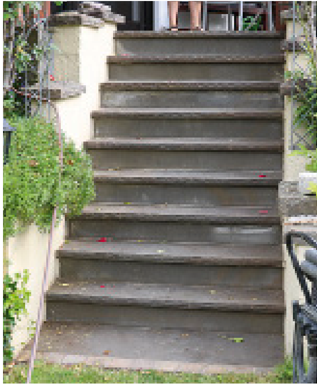
Bild 94 Ausblühungen auf Treppenstufen [Quelle: Rohowski]
