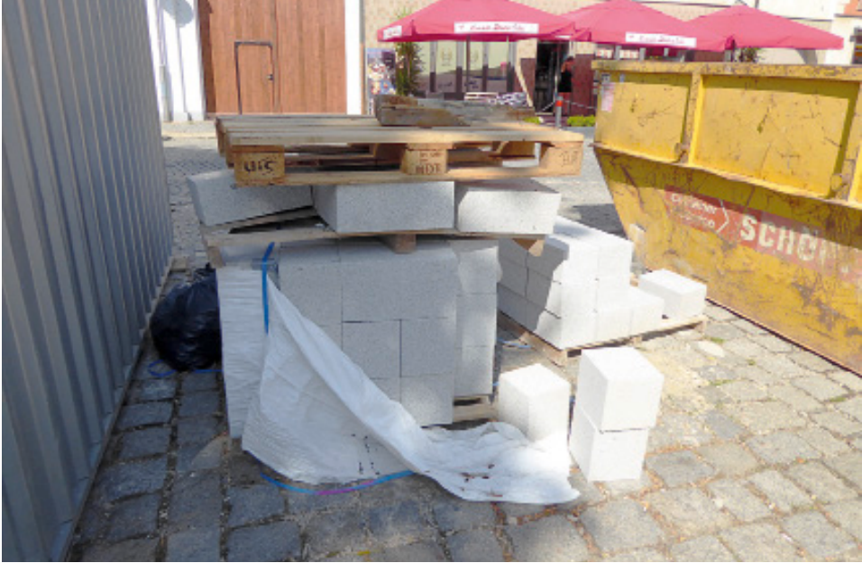
Bild 87 Ungeeignete Lagerungsbedingungen [Quelle: Burgetsmeier]
