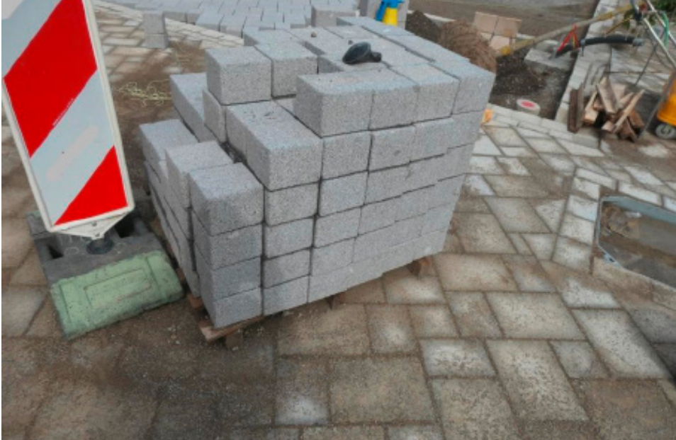
Bild 95 Die bereits verbauten Werksteine sind als Folge des Einschlämmens mit Kalkbrechsand verfärbt (Vergleich unverbaut auf Palette und ausgeführter Belag) [Quelle: Burgetsmeier]
