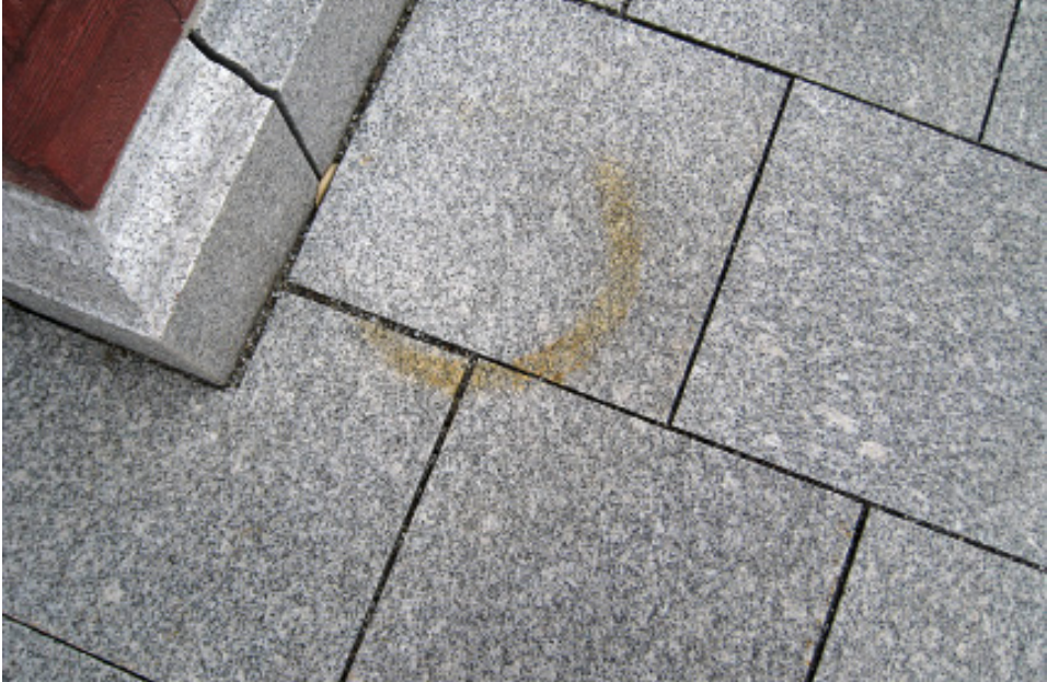
Bild 122 Lösliche Bestandteile, die sich auf der Oberfläche ablagern, hier mit einer Randbildung aufgrund des Aufstellens einer Topfpflanze verursacht [Quelle: Reckling]
