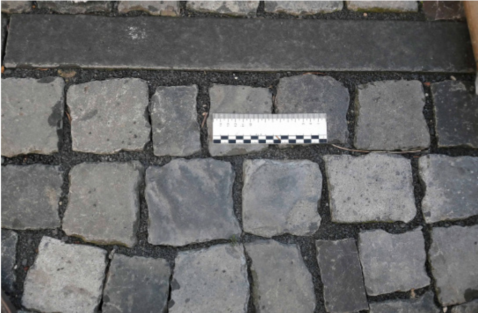
Bild 148 Pressfugen und Abplatzungen an bruchrauen Naturwerksteinen [Quelle: Rohowski]
