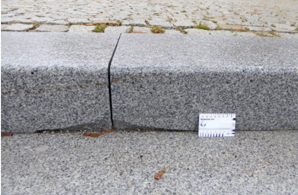
Bild 108 Sichtbarer Gesteinsverlust als Folge technischer Mängel [Quelle: Burgetsmeier]
