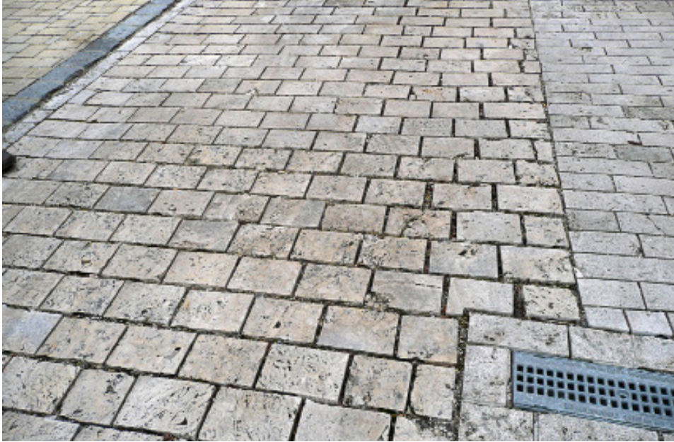
Bild 125 Bei hohlräumreichen Natursteinen sind Eck-/Kantenabplatzungen unvermeidbar [Quelle: Burgetzmeier]
