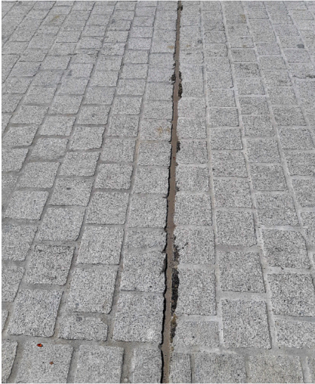
Bild 101 Randzonenverfärbung im Bereich der Bewegungsfugen durch nicht fachgerechten Primervoranstrich [Quelle: Schaller]
