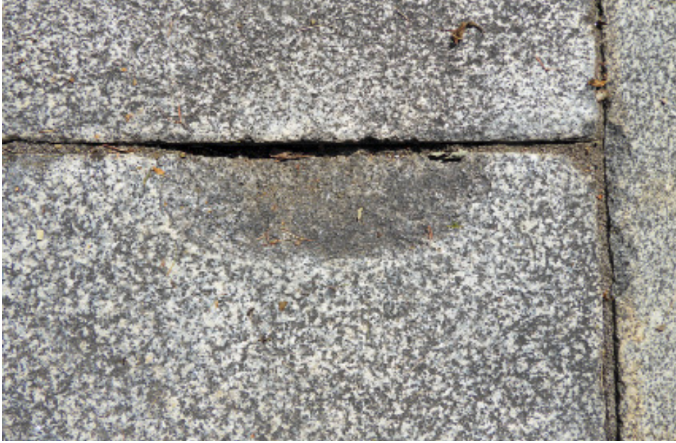
Bild 145 Muschelförmige Abplatzung mit mehreren Zentimetern Breite [Quelle: Burgetsmeier]
