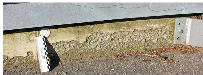
Abb. 16 a+b: Frost-Tausalz-bedingte Abwitterungen an den vertikalen Wandflächen der Mauerscheiben, die neben einer Fahrbahnfläche verbaut wurden
