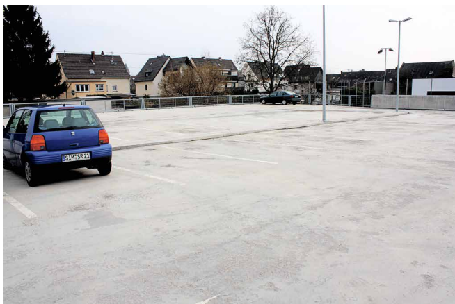
Abb. 15 a+b: Frost-Tausalz-Schäden aufgrund falscher Betonbestellung
