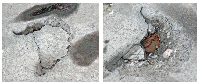
Abb. 30 a-c: Zementsteinabwitterungen oberhalb witterungsunbeständiger Gesteinskörner
