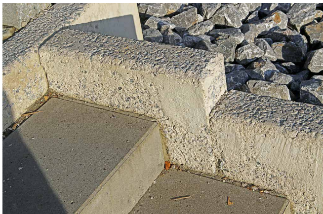
Abb. 17 a+b: Frost-Tausalz-bedingte Abwitterungen an den vertikalen Wandflächen der Mauerstufen einer Treppenanlage
